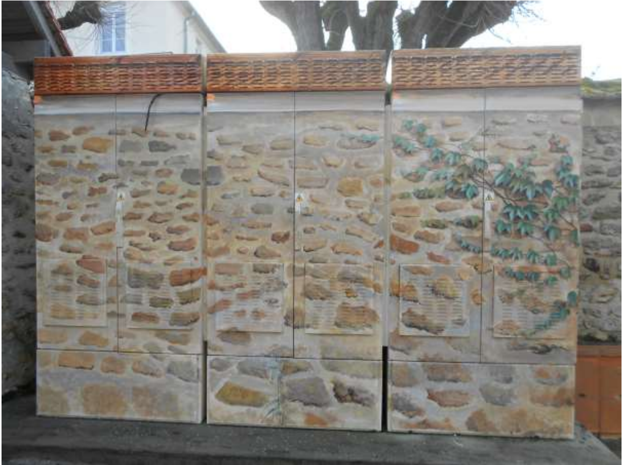
Ça n'en a pas l'air mais c'est un transfo EDF
